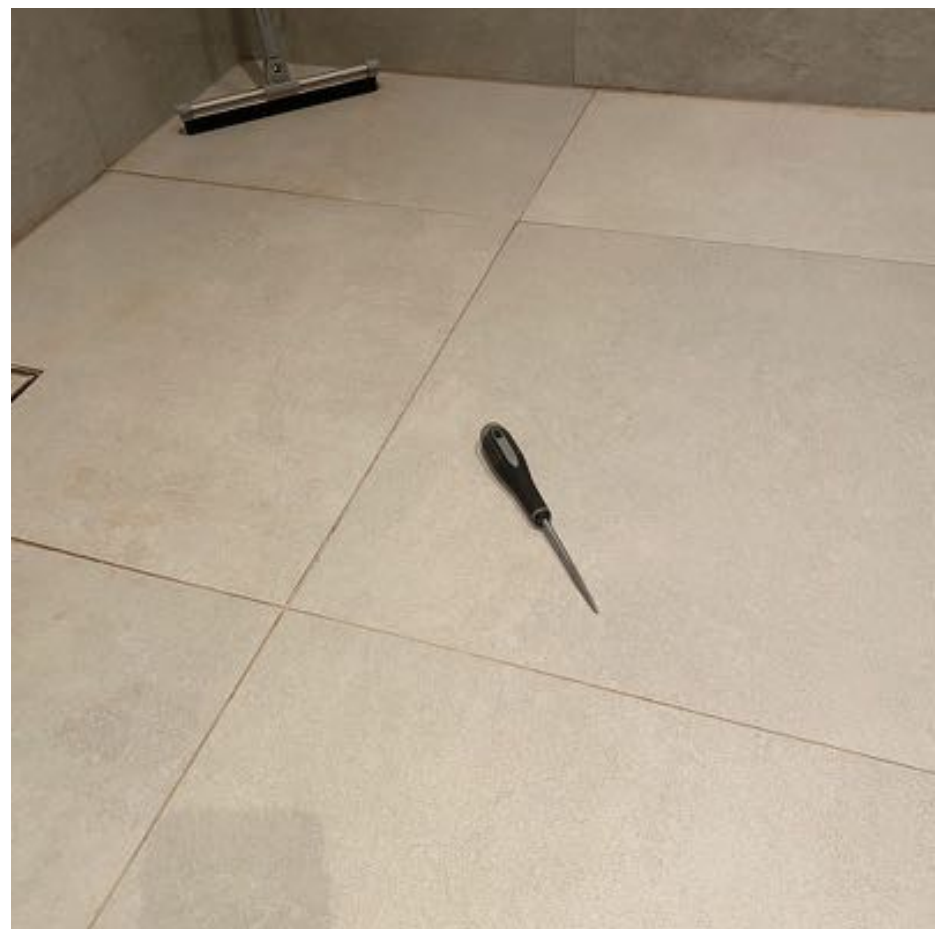
6. Huomio: Pesuhuoneen lattialeattojen kiinnitys on paikoin heikko (kopolaattoja). Riskinä on laattojen halkeilu. Alustastaan irronneet laatat eivät aiheuta välitöntä korjaustarvetta, mikäli laattasaumat sekä laatoituksen taustalla oleva vedeneriste pysyvät ehjinä.
