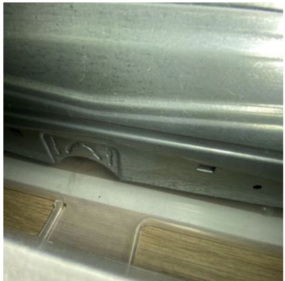
18. Yleiskuva: Astianpesukoneen alle on asennettu ohjeiden mukaisesti vuotokaukalo (kaukalo havaittu koneen alasokkelin takaa).
