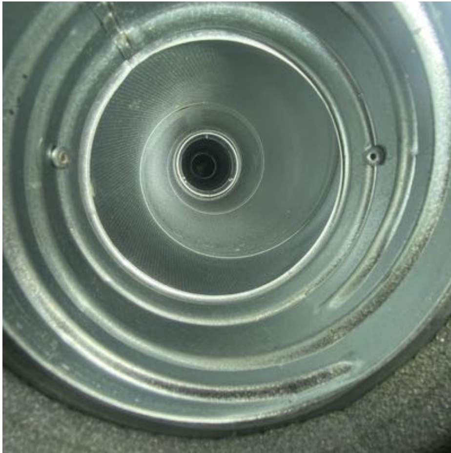
15. Yleiskuva: Ilmanvaihtokanavat vaikuttavat puhtailta märkätilojen ja wc-tilan osalla. Ilmanvaihtokanavat tulee puhdistaa säännöllisesti ammattilaisen toimesta sisäilman laadun varmistamiseksi.
