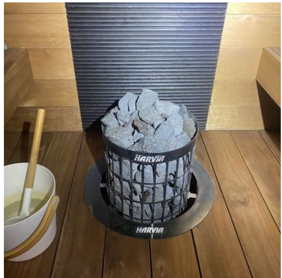
2. Kiukaan eteen ei ole asennettu kaiderakenteita. Suosittelaa kaiteen asentamista kiukaan eteen turvallisuuden lisäämiseksi.
