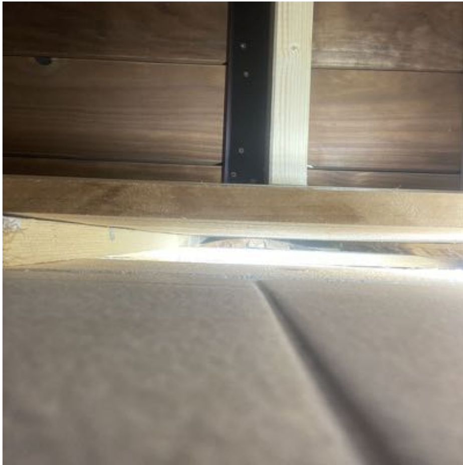
3. Yleiskuva: Saunan paneeliseinän takaa havaittiin tuuletusrako.
